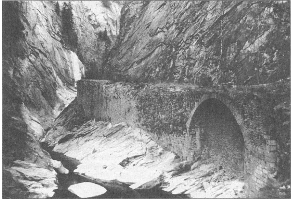
fig. 9: Abbandonata da quasi sessantanni la vecchia strada cantonale del Piottino è ormai invasa dalla vegetazione e corrosa dal tempo. Il degrado dei muri si è accelerato a partire dall'inverno 1991-92. Se non si interverrà presto questa strada è destinata a scomparire. Foto IVS: G. Bellini.
